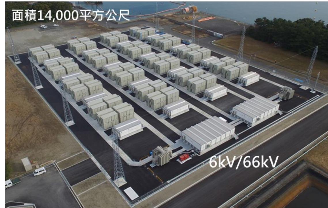
日本經產省-50MW/300MWh
